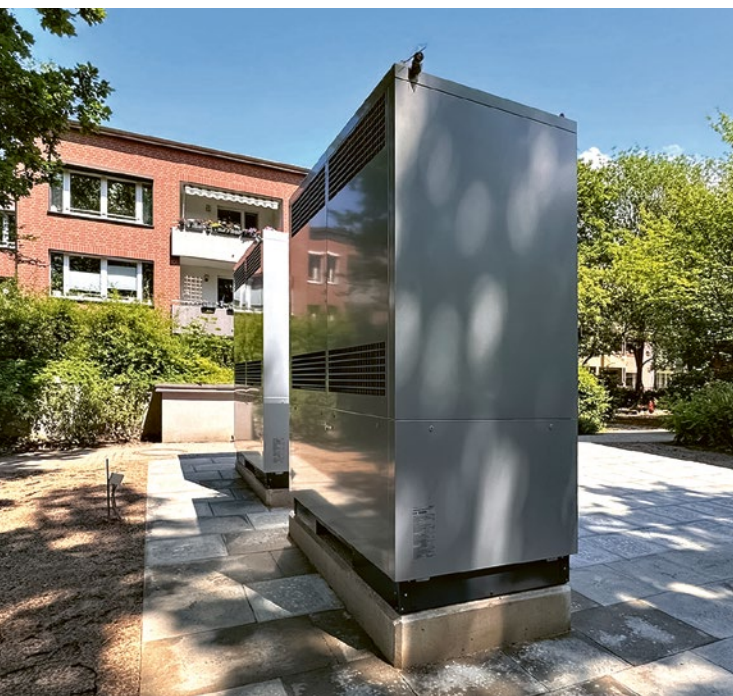
Moderne Technik in der Wohnanlage Mergenthaler Weg/Pinneberger Chaussee: Die Photovoltaikanlage auf dem Dach (Bild oben) erzeugt klimaneutralen Strom, der für den Betrieb der Wärmepumpen (Bild unten) genutzt wird.
